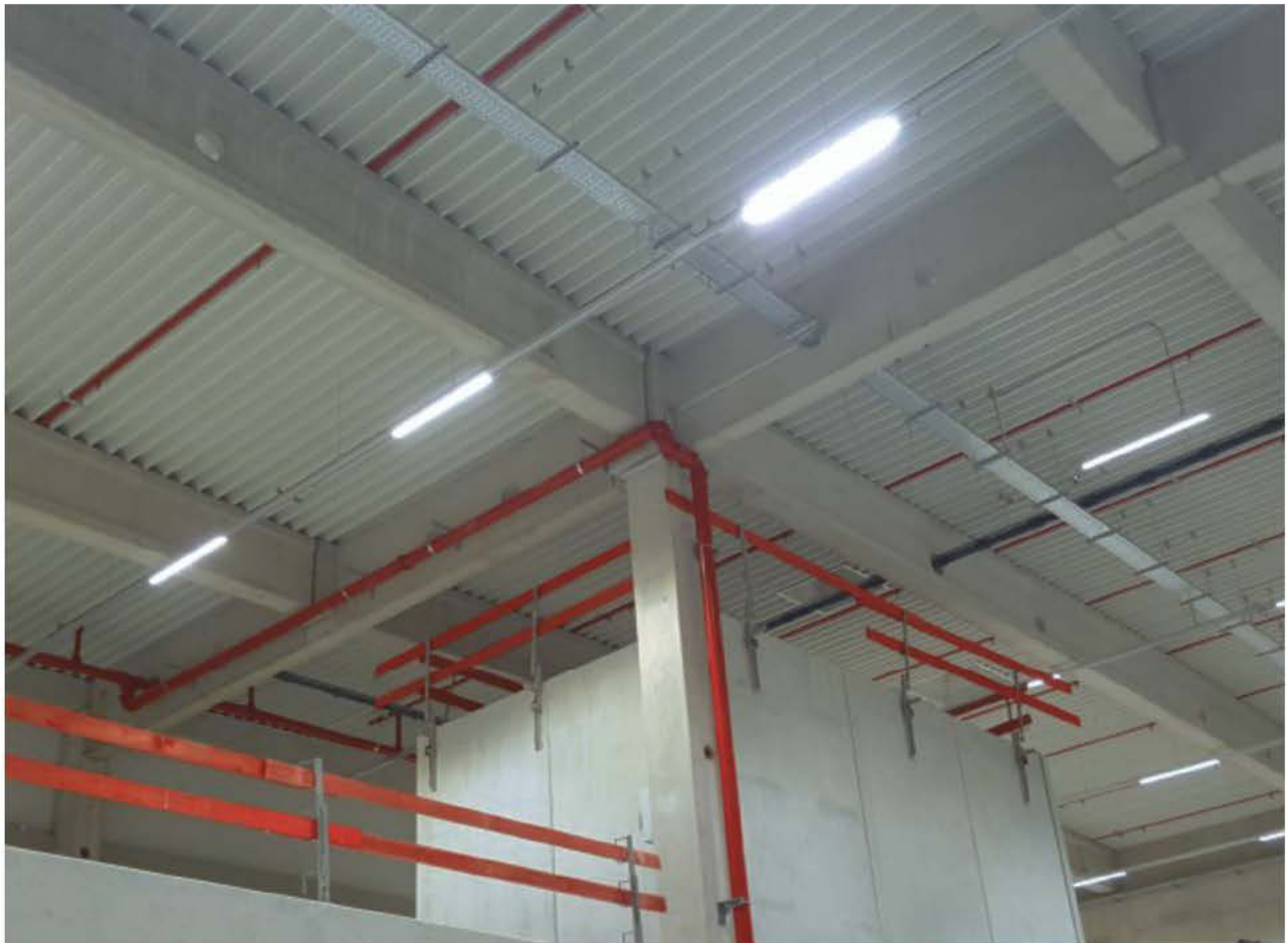
Logistikhalle mit Hochregalbeleuchtung
