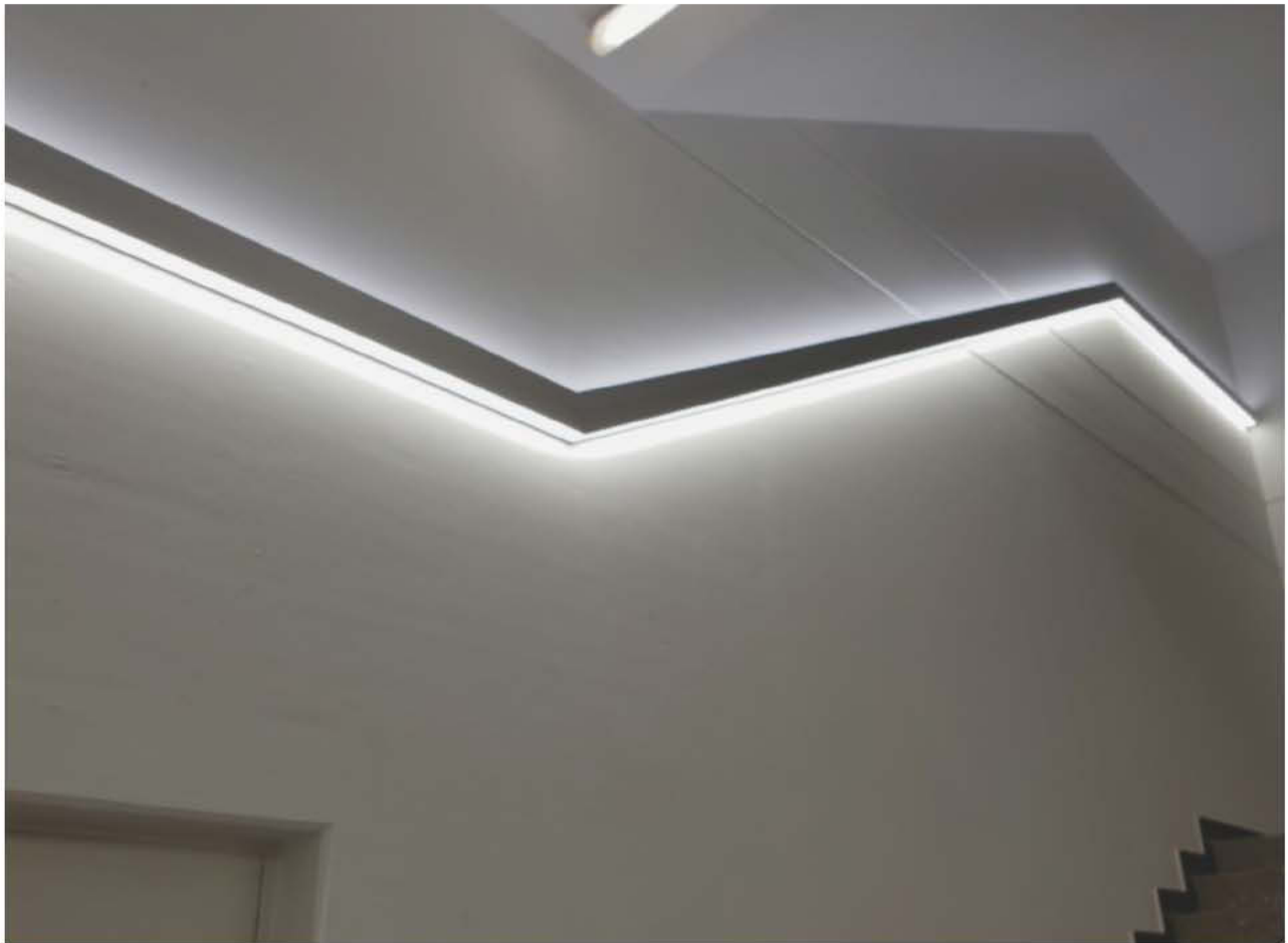
Lichtkanal der Treppenführung an der Wand montiert – Licht wird nachgeführt
