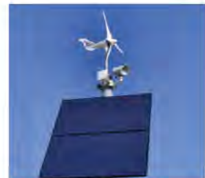
Wind- und Solarbetrieb 24/7CCTV
