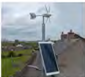
Wind- & Solarbetriebene Straßenbeleuchtung
